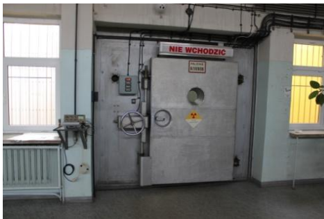
3. Przejście do osłony reaktora, w której panuje niewielkie podciśnienie, odbywa się poprzez służbę ciśnieniową.
